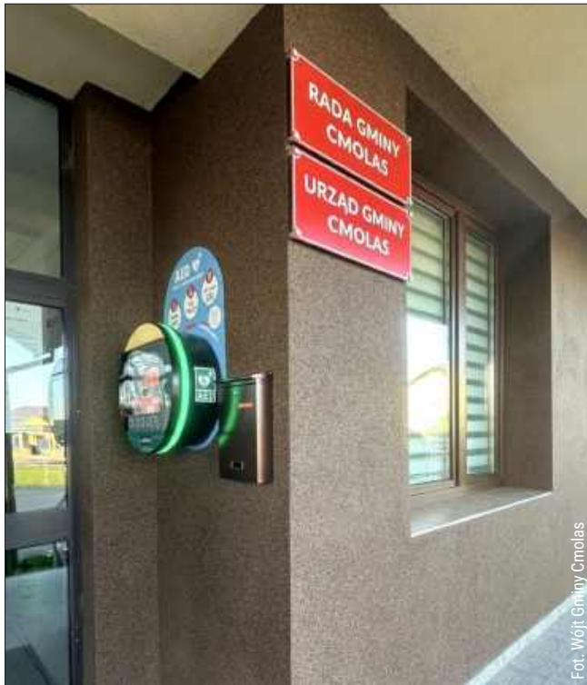
Jedno z urządzeń pojawiło się na ścianie budynku Urzędu Gminy w Cmolasie.
