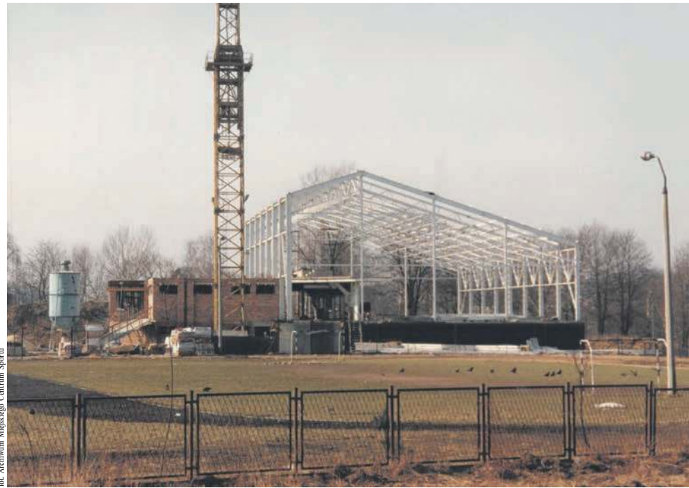
Trwa budowa krytej pływalni w Dolinie Chechła, obok SP nr 8 w Chrzanowie
