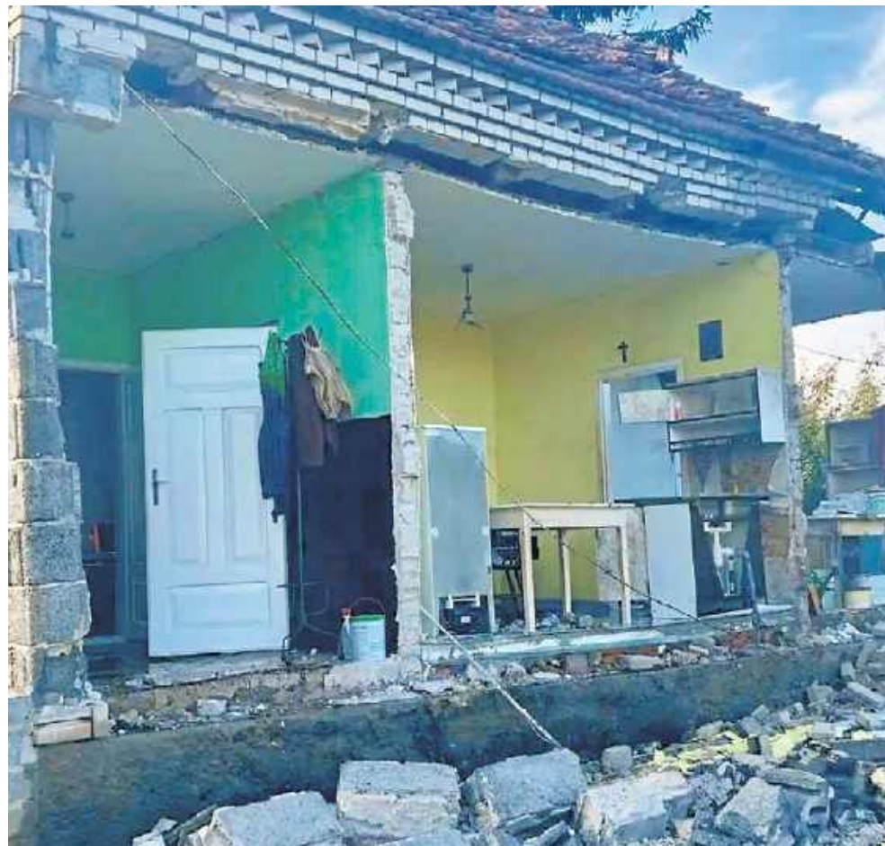
Jedna część domu praktycznie przestała istnieć. Ściana zmieniła się w kupę gruzu
