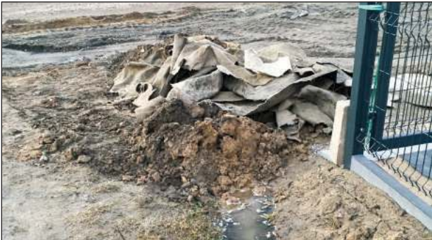
Przesłane przez Czytelnika zdjęcie obrazuje zasypany ciek wodny, który o tej porze roku znacznie osusza drogę. Teraz woda nie miała ujścia
