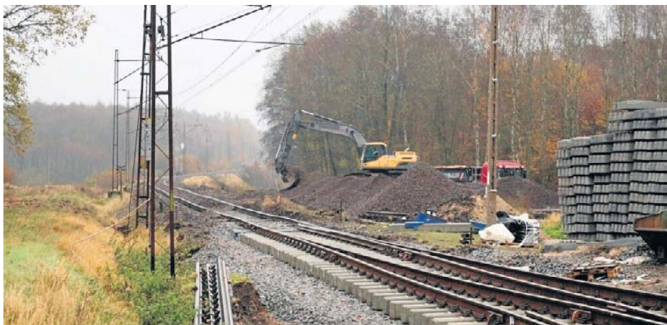
Na czas wstrzymania ruchu pociągów przewoźnicy – Polregio i – PKP Intercity uruchomią zastępczą komunikację autobusową
