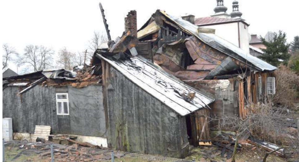
Spalił się dach, zawalił strop, wypaliło wyposażenie
