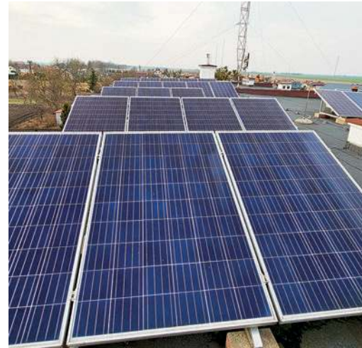
Panele fotowoltaiczne na budynku Urzędu Gminy
