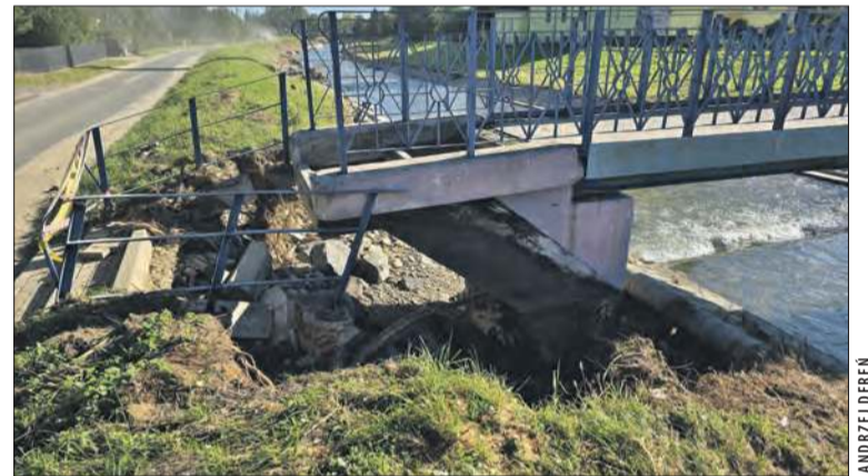
Zniszczone przęsło kładki w Łące Prudnickiej
