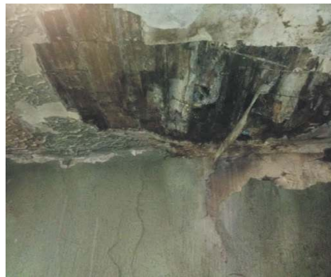
Dziura w suficie w jednym z pomieszczeń
