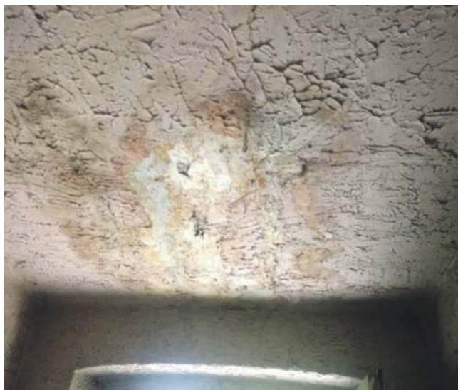
Zalany sufit w kolejnym pomieszczeniu
