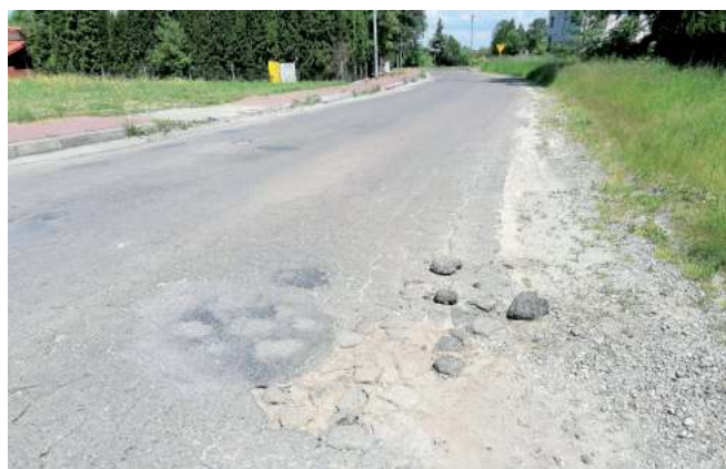
Ul. Przedmieście sypie się. Asfalt jest mocno popękany
