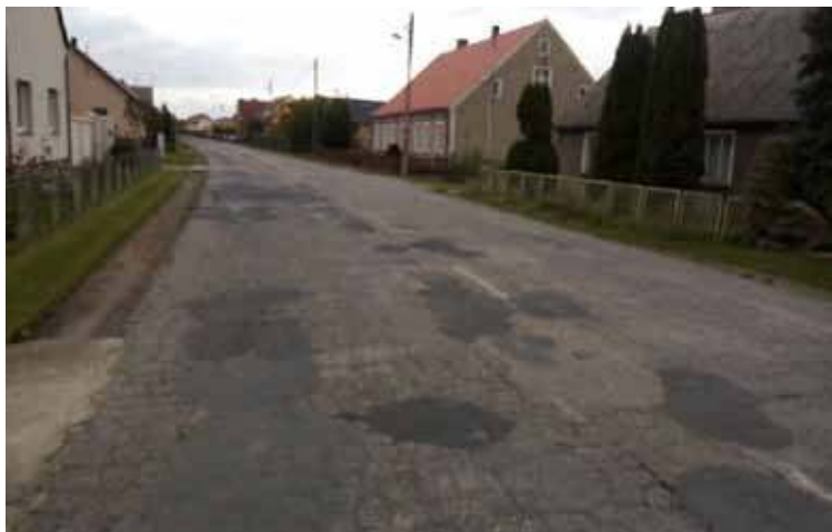
Droga w miejscowości Wiechowo od wielu lat wymaga remontu
