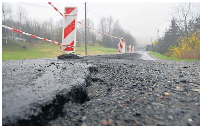
Osuwisko w Grabnie zostanie ustabilizowane, żeby nie zagrażało już drodze powiatowej
