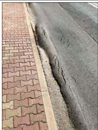
Asfaltowe „garby” na drodze mogą być niebezpieczne.
