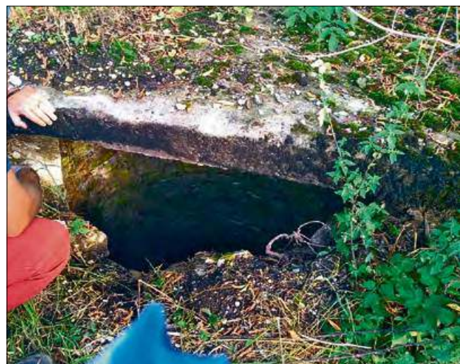
Łatwo przeoczyć niebezpieczną pułapkę w tych chaszczach - jeden krok i może dojść do wypadku.
