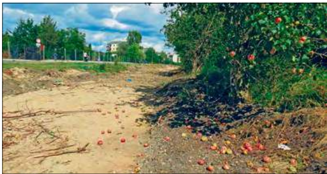
Ścieżka jeszcze nie jest utwardzona, ale już teraz widać, że będzie problem ze spadami.
