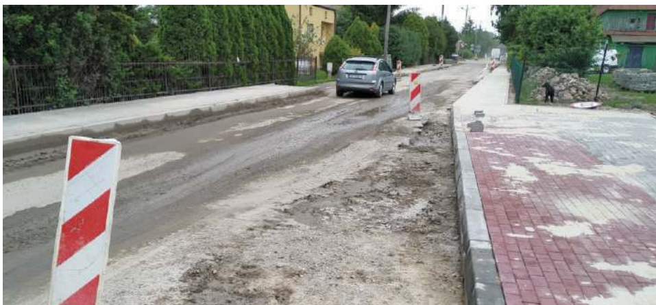
W pewnym momencie droga i chodnik na ul. Kościuszki ulegają gwałtownemu zwężeniu
