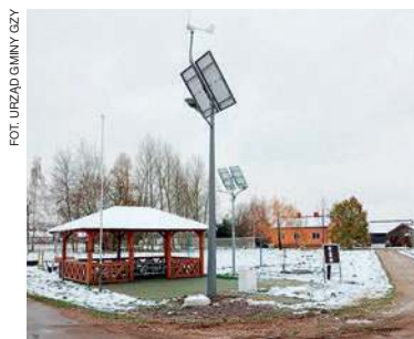
W gminie zamontowano sześnaście lamp
