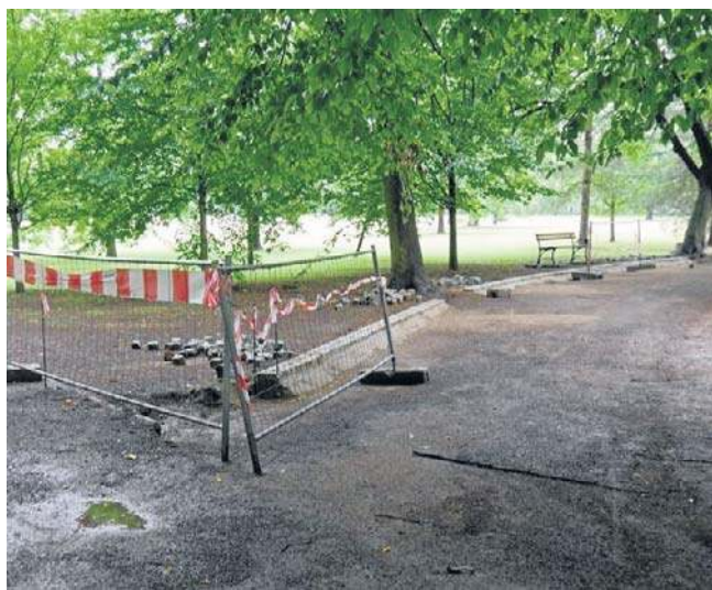
Alejki w części angielskiej parku wymagają remontu
