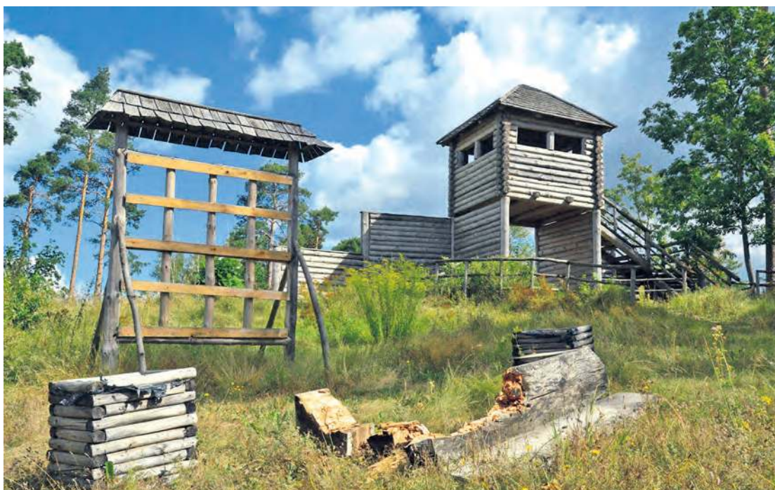
Stan drewna i konstrukcji jest słaby. Także most na wyspie nie jest stabilny, spacer po nim mógłby być niebezpieczny i utrudniony przez zarośla.
