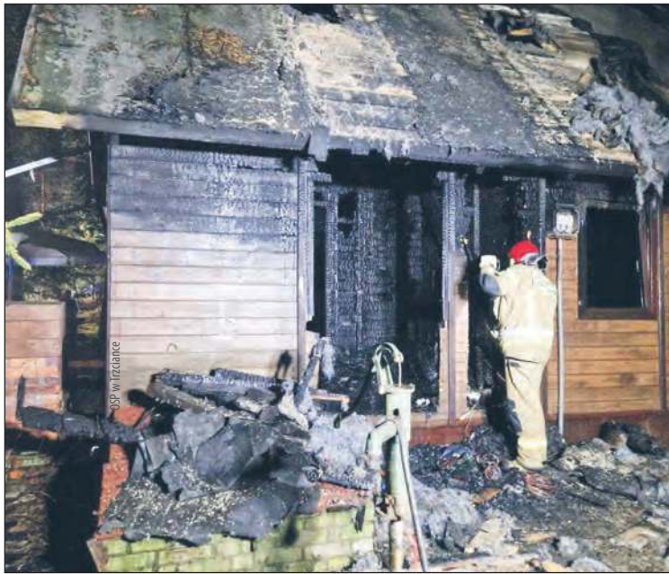
W poniedziałkowy wieczór, 19 sierpnia, doszło do pożaru domku letniskowego na Osiedlu Wilga przy ul. Rajskiej. W akcji gaśniczej uczestniczyło sześć zastępów straży pożarnej
