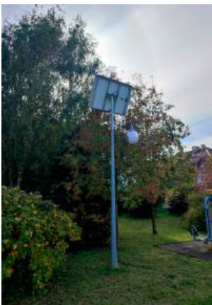
Choć słońce nie brakuje, solarna latarnia przy ul. Kamińskiego nie świeci już od dłuższego czasu
