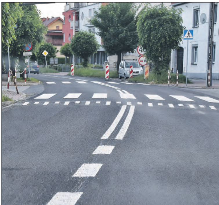
Trwają prace na ulicy 3 Maja w Głogówku. W ramach inwestycji Powiatu Prudnickiego położona już została nowa nawierzchnia jezdni oraz wymalowano oznakowanie poziome. (d)
