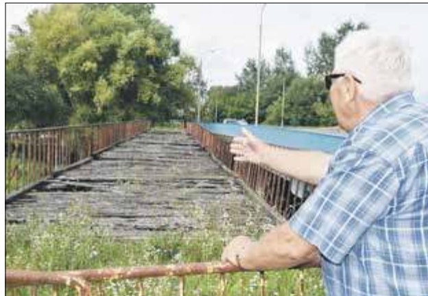
Mieszkaniec Białej Podlaskiej zauważa, że na moście drewno jest zbutwiałe, a balustrada wygląda jakby miała za chwilę się oderwać
