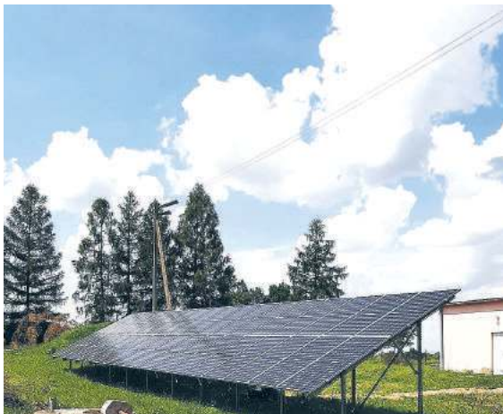
Instalacja fotowoltaiczna w Surhowie
