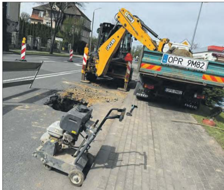
Głęboka dziura pojawiła się na jezdni drogi krajowej
