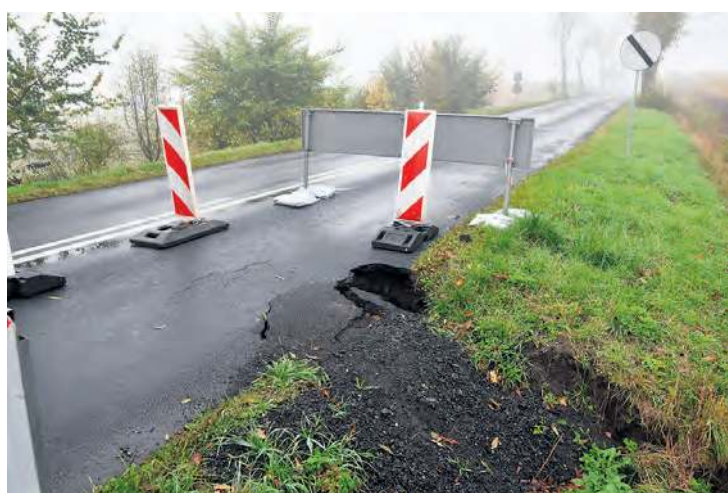
Między Kiełpinem a Wielką Komorzą asfalt dosłownie się zapadł. – Przewróciły się tam ścianki na przepustach. Owe przepusty mają około 90 lat. Po prostu nie wytrzymały próby czasu – informuje Janusz Dąbka.
