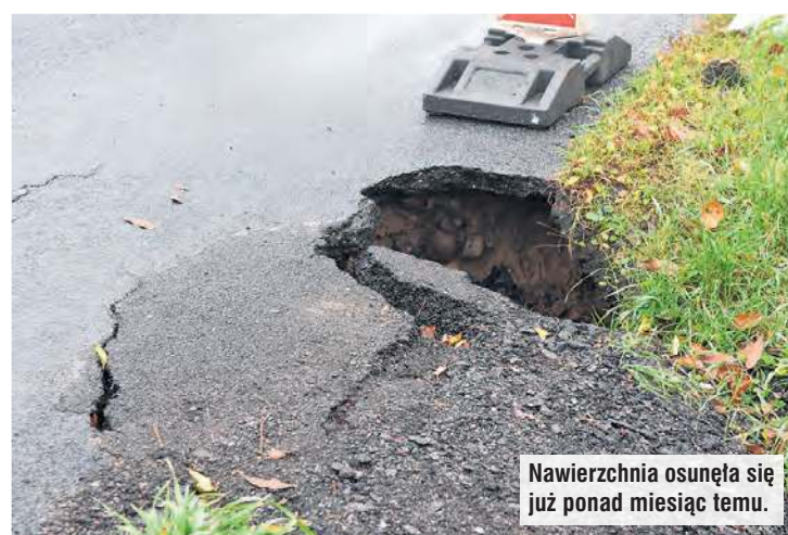
Aby ominąć niebezpieczne miejsce, trzeba całkowicie zjechać na lewy pas, innej możliwości nie ma.
