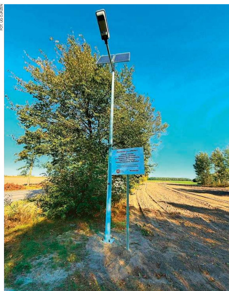
Lampy solarne na terenie gminy Ojrzeń
