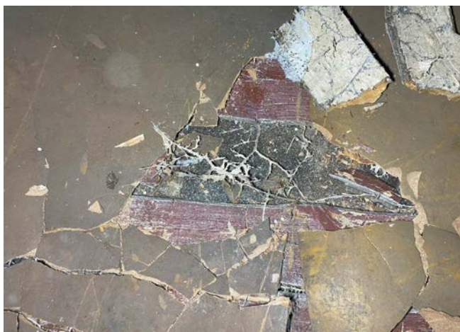
FOT. 8 Sznury grzybniowe pod drewnianą podłogą; fot.: autor
