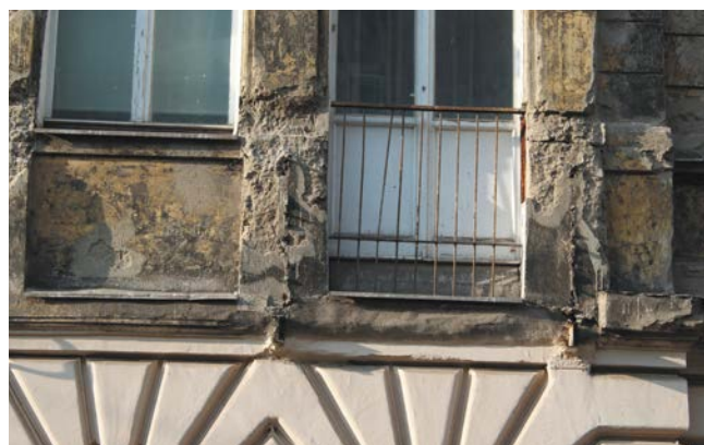
FOT. 1 Często stosowana pierwotna koncepcja konstrukcji balkonów; fot.: autor
