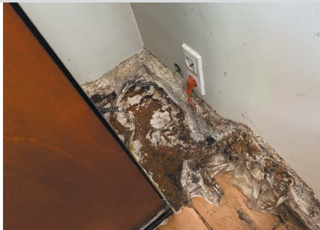
FOT. 10 Zdeformowany owocnik w miejscu, w którym grzyb przerósł przez ścianę; fot.: autor
