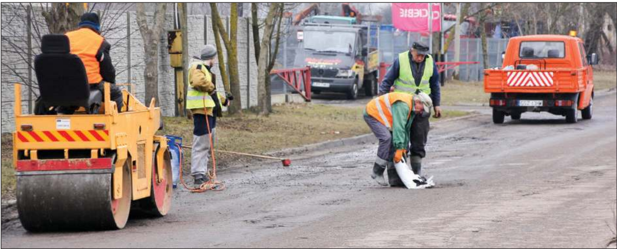
■ Parę lat temu przedsiębiorcy z ul. Kolejowej w Rykach na własny koszt załatali dziury. Gdyby gmina przejęła ulicę, to wzięłaby na siebie również utrzymanie drogi. Teraz nie może nawet przeprowadzić remontu (fot. archiwum)
