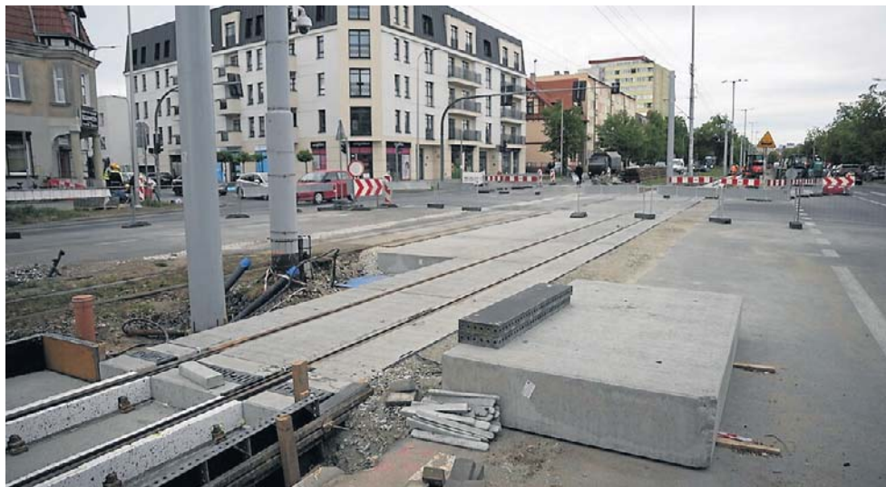
Tak wyglądał stan prac na modernizowanym torowisku tramwajowym na ulicy Kościuszki w miniony poniedziałek
