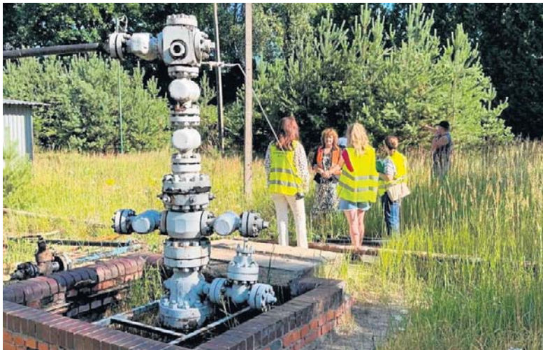
W tym miejscu doszło do groźnego wycieku toksyn
