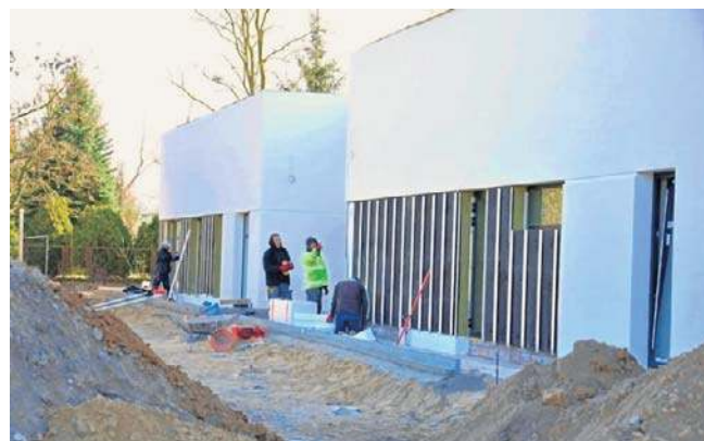
Budowa żłobka. Równolegle trwają działania mające na celu wybór dyrektora placówki i nabór pracowników
