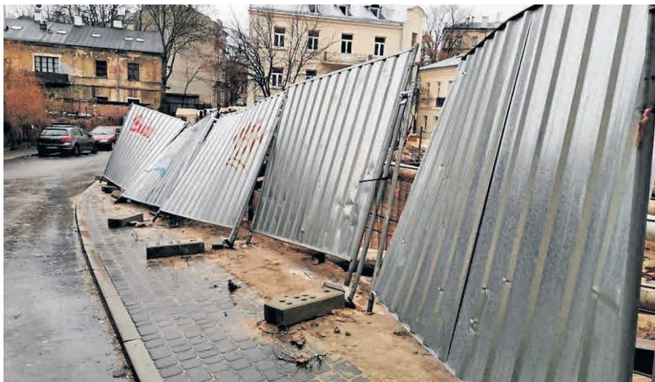
Woj. lubelskie odwiedziły wczoraj silne wiatry, w porywach osiągały prędkość nawet do 95 km/h. Tak w poniedziałek rano po przejściu wichury wyglądała ul. Żmigród w Lublinie
