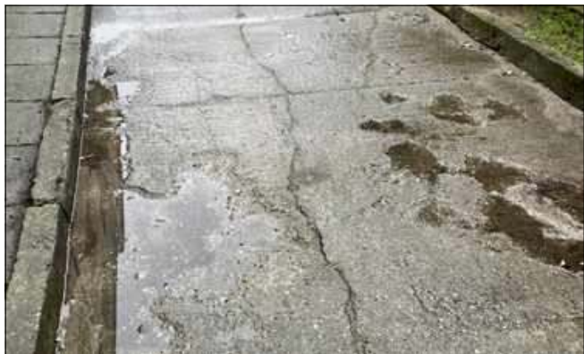
Droga pod blokiem nadal dziurawa i brzydka.
