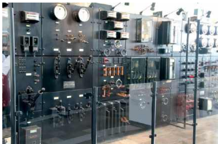
Panel sterowania dużego generatora wysokiej częstotliwości
