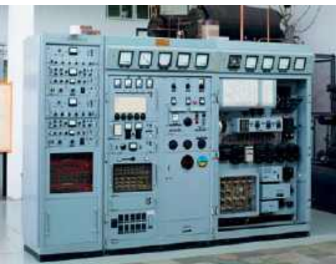
Duży nadajnik krótkofalowy stacji radiowej Grimeton zbudowany przez niemiecką firmę Telefunken
