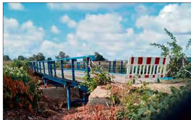
Nurt powodziowej fali rzeki uszkodził konstrukcję nośną i podmył fundamenty przyczółka mostu.
