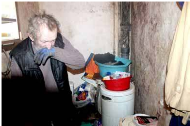
Łazienka jest cała zawilgocona
