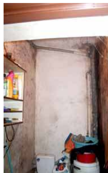
Na ścianie łazienki jest ogromny grzyb
