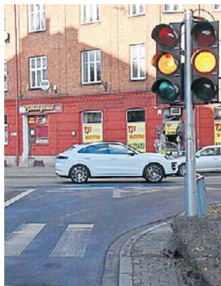
Sygnalizacja ma mieć nowoczesne sterowniki
