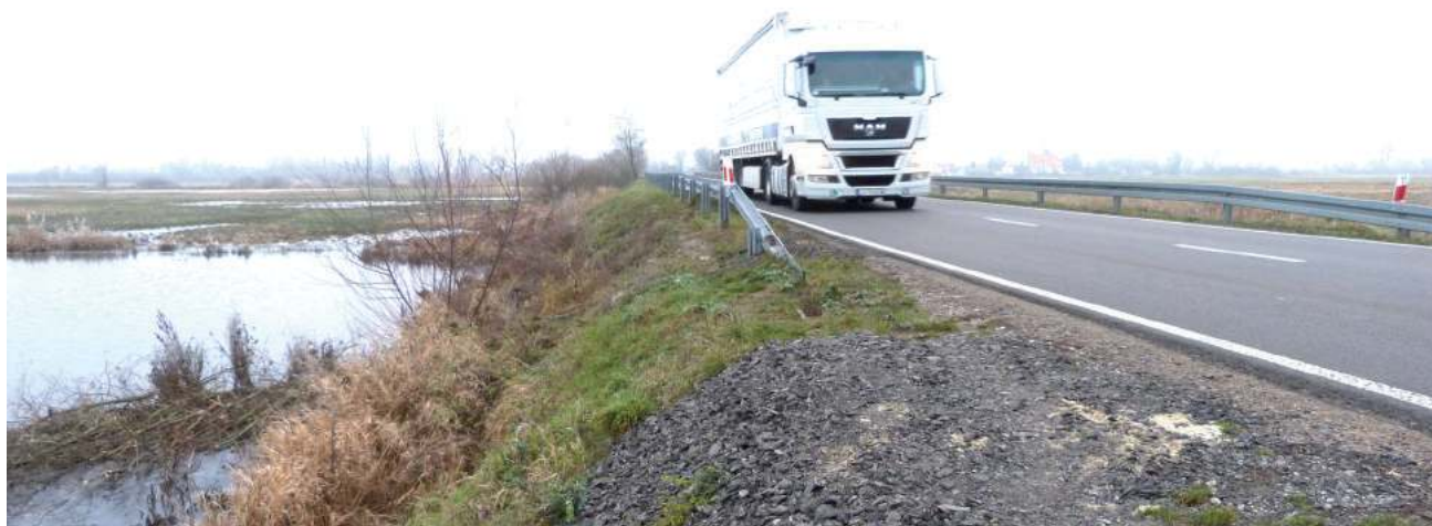
Okazało się, że zniszczeniu uległ korpus drogowy, czyli pobocze i skarpa nasypu na powierzchni około 20 mkw. z obu stron jezdni. Przyczyną uszkodzeń była działalność bobrów
