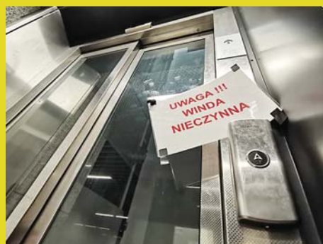
Winda w tunelu znowu do naprawy | 4
