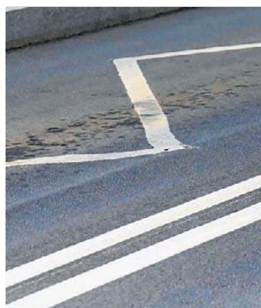
Przy przystankach widać wyżłobienia w asfalcie
