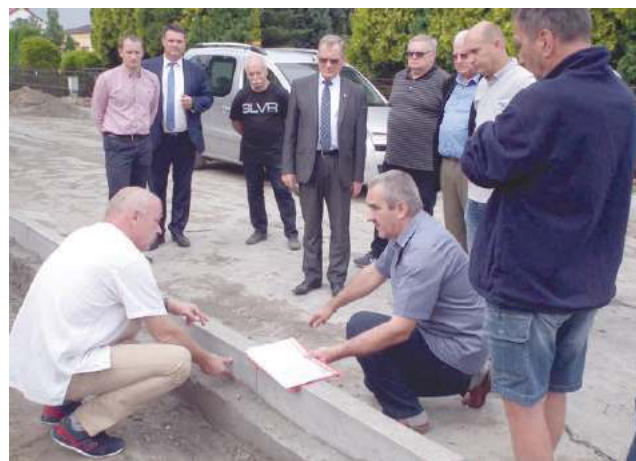
Kwestią nie do pogodzenia okazała się wysokość krawężników oraz zaplanowany sposób odpływu wód opadowych
