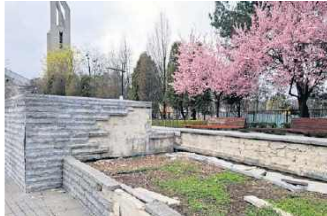
Fontanna w sercu osiedla Chemików, sprawa przygnębiające wrażenie. Odpadają tynki i posucha
