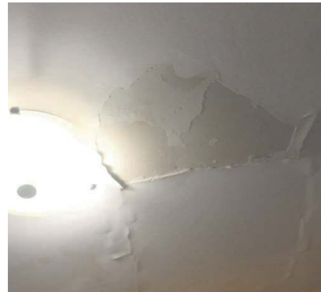
Zalany sufit zostanie wyremontowany
