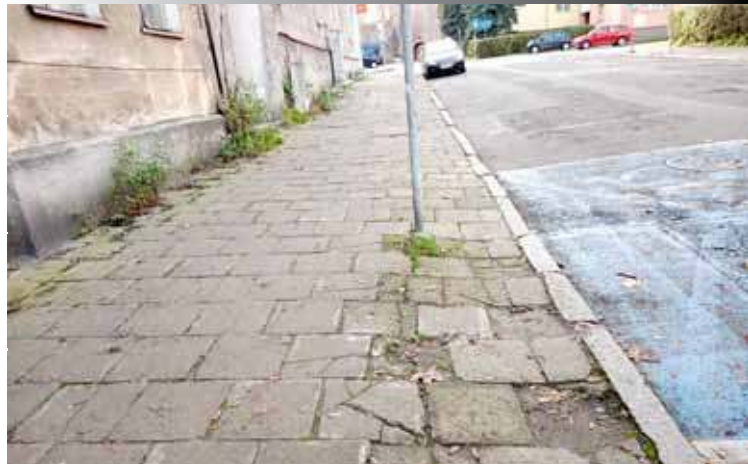
Miejmy nadzieję, że do deklarowanej naprawy nawierzchni dojdzie szybko
