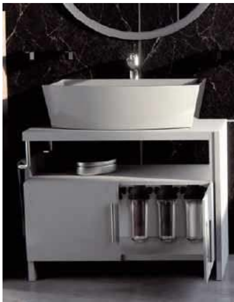
🔹 Filtry do uzdatniania wody zamontowane w szafce pod umywalką. DAFI (FORMASTER)
