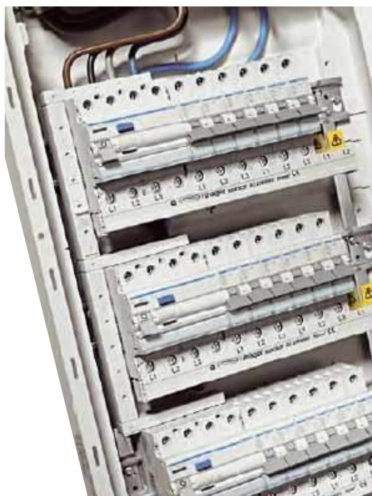
📍 Używane obecnie rozdzielnice przystosowane są do tzw. aparatury modułowej – montowanej na standardowej szynie i o znormalizowanej szerokości. HAGER (BERKER)
