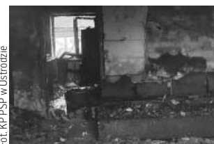
Zniszczony w pożarze dom trzeba zabezpieczyć przed zimą
