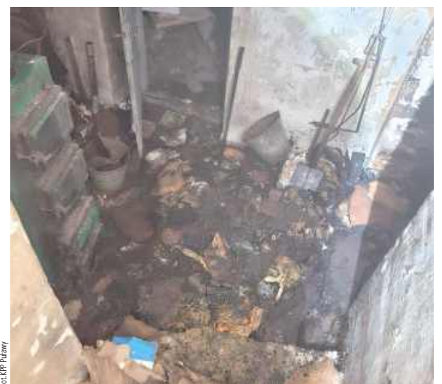
Ogień pojawił się w kotłowni. 71-latek próbował ugasić pożar samodzielnie, niestety uległ poważnym poparzeniom
