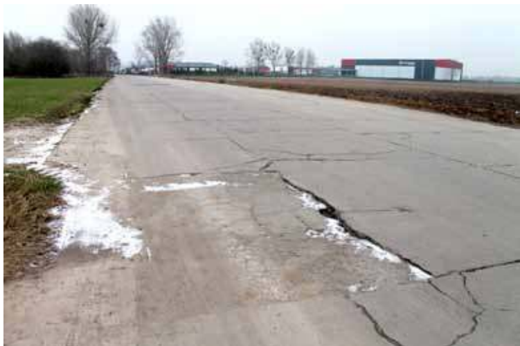
To zdjęcie zostało wykonane 7 grudnia. Wtedy na łamach Dziennika sygnalizowaliśmy problem dziury na Śniadeckiego
