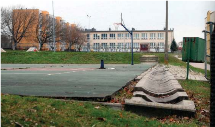
Stare boisko przy SP nr 30 nie nadaje się do użytku
