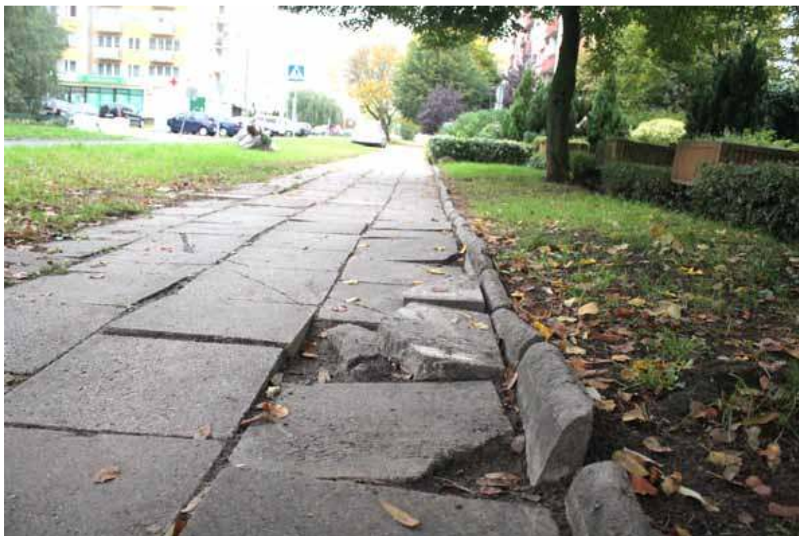
Chodniki na ul. Czeskiej wymagają naprawy
