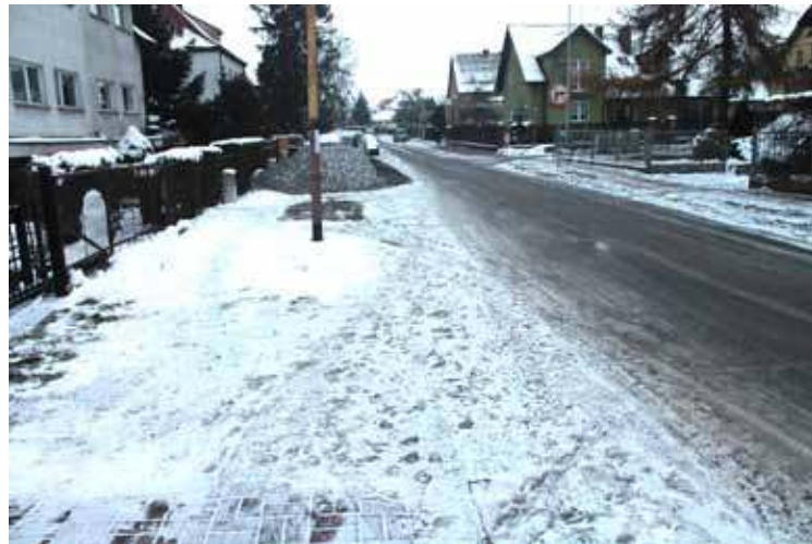
(zdjęcie z grudnia 2021 r.) Mieszkańcy wnioskują, aby ponad 30-metrowy fragment chodnika został uzupełniony
