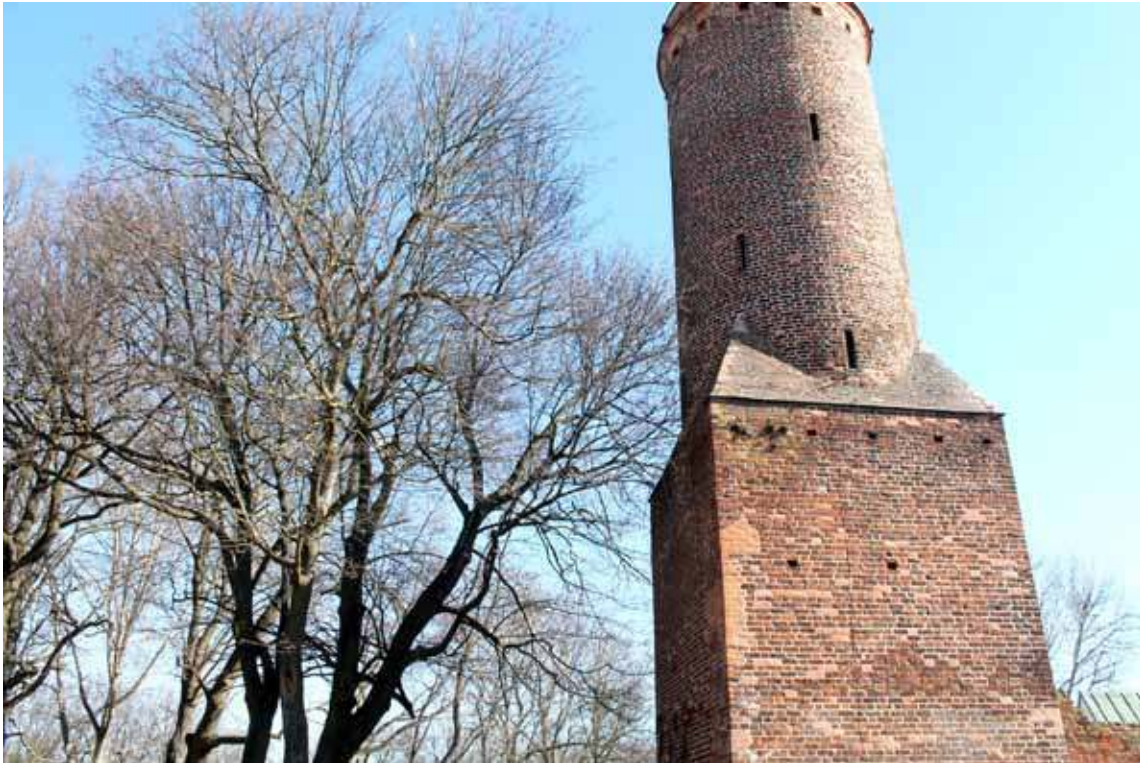
Gałęzie drzewa dotykają muru górnej części Baszty Białogłównki, co może doprowadzić do uszkodzenia ściany.
